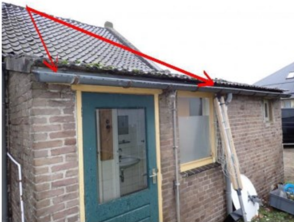
Vlakke plaat achter de goot
