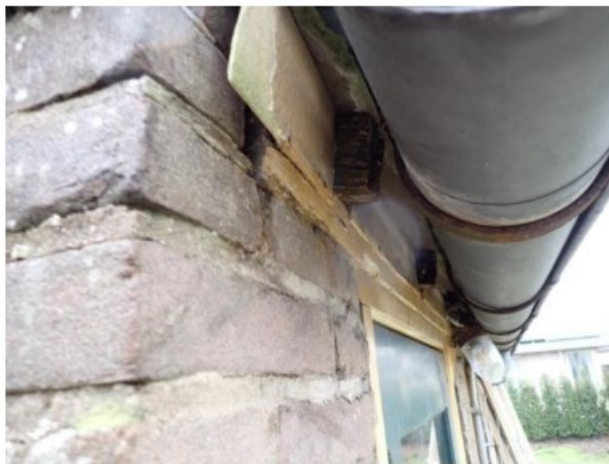
Vlakke plaat achter de goot
